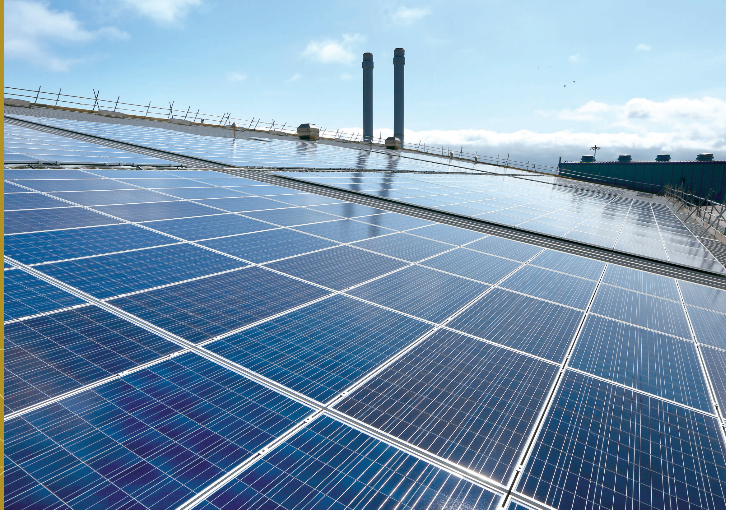
Northumbrian Water – 安裝於蒂賽德 (Teesside) Bran Sands 污水處理設施的太陽能採光板，以支持其於二零二七年前達至淨零排放的遠大目標。
